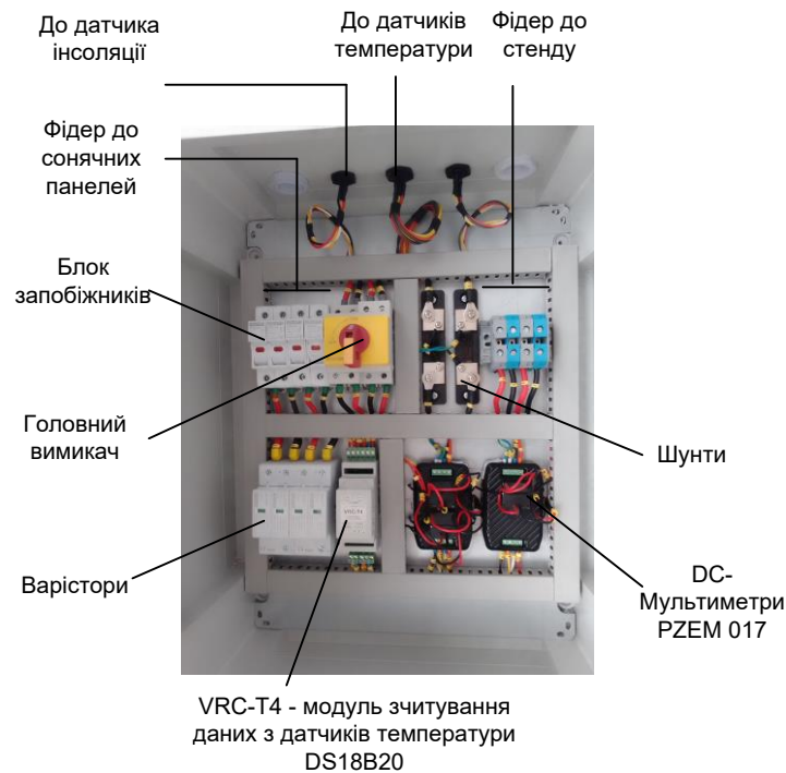
Рисунок 5 – Щит підключення фотоелектричних модулів (5-й поверх ННІАЕ)
